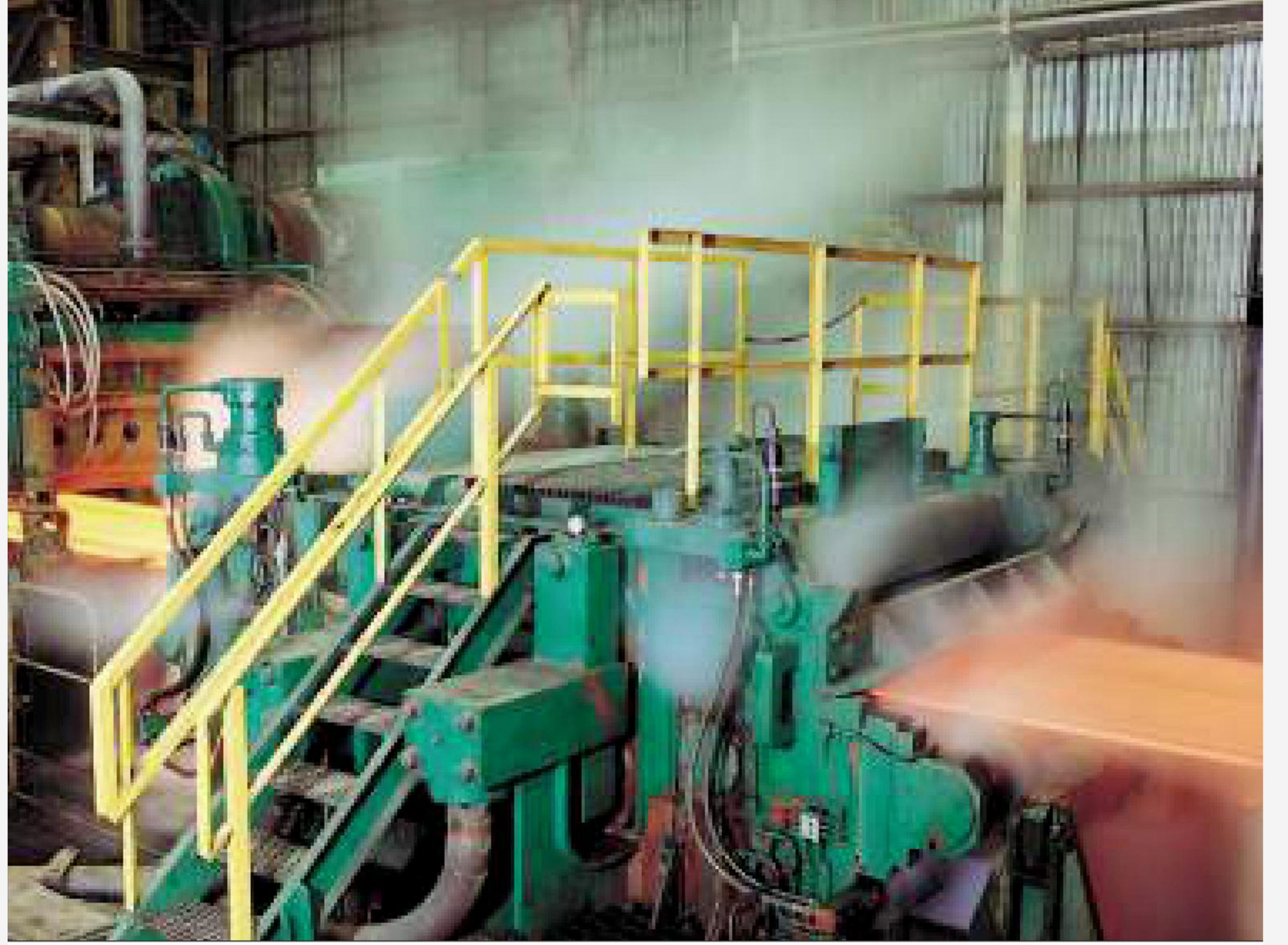
İnce levha döküm fabrikasının haddehanesinin önünde kireç çözücü
